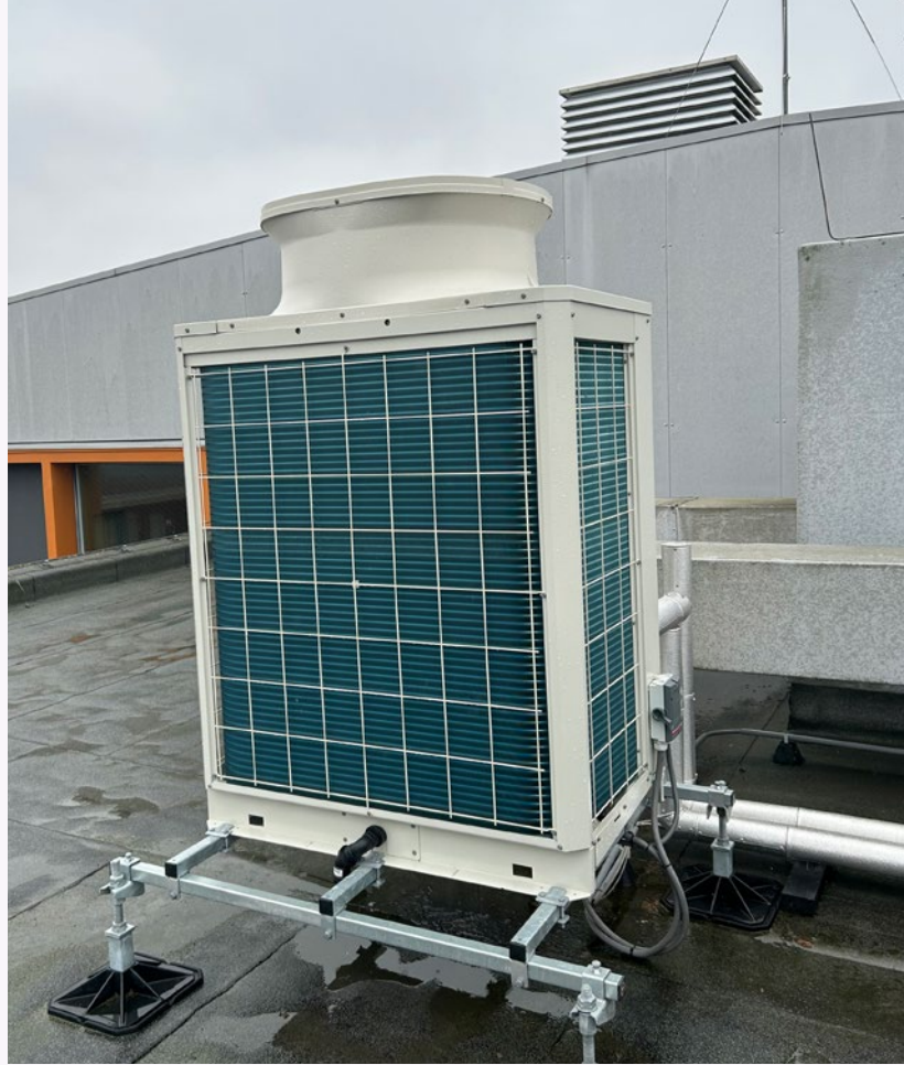
De Parnassia Groep heeft een warmtepompboiler geplaatst met behulp van de DUMAVA-subsidie op locatie Den Haag.
